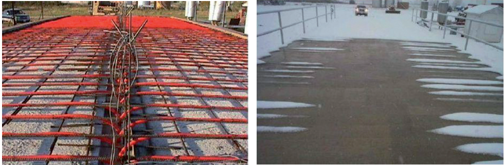
Rys. 2.3. Most w Weatherford, z lewej instalacja rozmrażania w trakcie budowy, z prawej efekt działania instalacji
