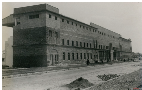
Ryc. 8. Stadion Legii w Warszawie Widok trybun od ulicy Myśliwieckiej, obiekt w trakcie budowy, ok. 1929
